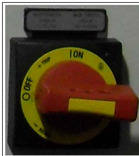
Fig. 7: dispositif de sectionnement du réseau
