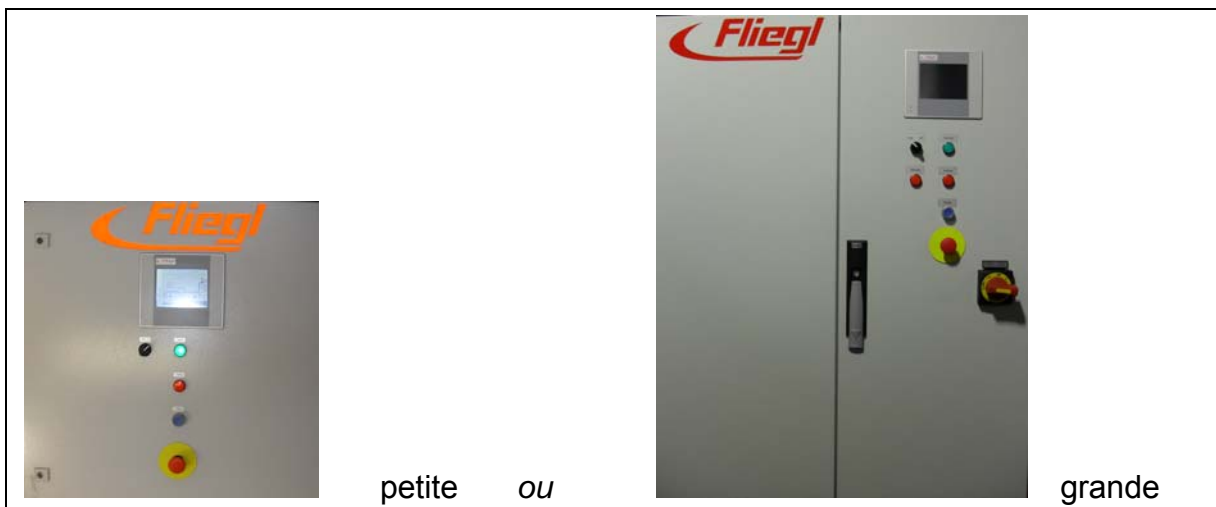
Fig. 2: Dispositifs de sécurité et de surveillance
